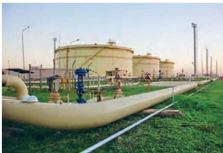
شکل ۲۱- نمایی از خطوط انتقال سوخت
